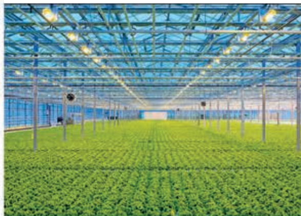
ООО СХП «ТЕПЛИЦЫ БЕЛОГОРЬЯ», БЕЛГОРОДСКАЯ ОБЛ., П. РАЗУМНОЕ (35 000 СВЕТИЛЬНИКОВ)
