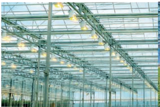
АО СОВХОЗ «ТЕПЛИЧНЫЙ», Г. ЮЖНО-САХАЛИНСК (25 000 СВЕТИЛЬНИКОВ)
